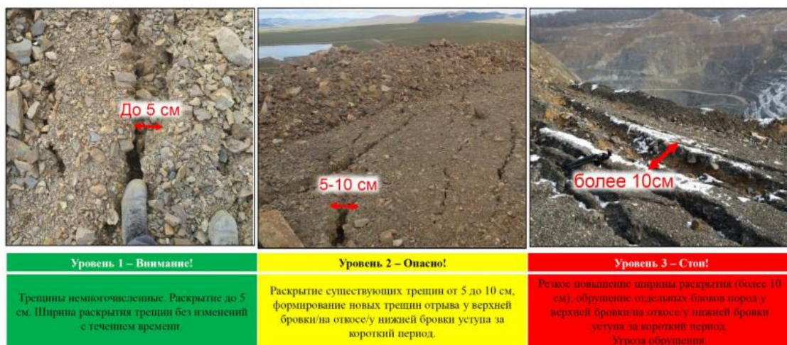
Рисунок 1 – Трещины отрыва (заколы)
